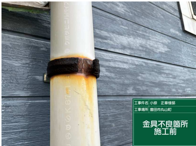
7 配管金具不良箇所 施工前
